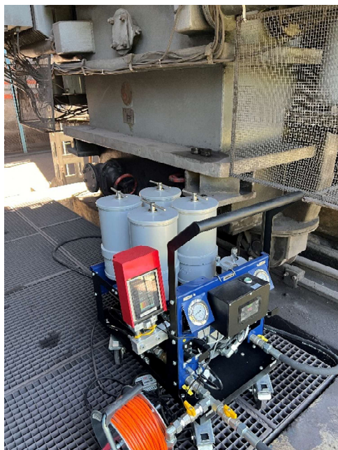
Obr. 23 Transformátor (zdroj: ECOFIL®) plnenie
