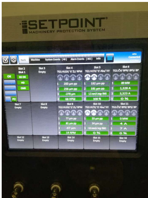
Obr.2 Pohľad na vibračný monitor Blok I VE Gabčíkovo (TG1 a TG2)
