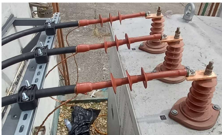
Obr.4 Nové vonkajšie káblové koncovky
