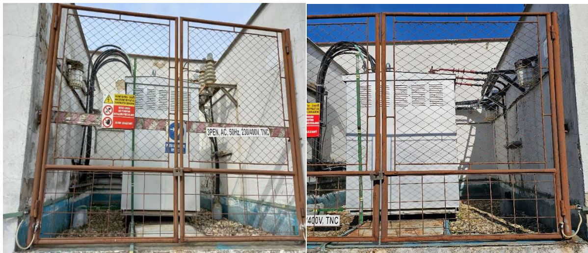
Obr.1 Stanovište transformátora TM2 a) pred výmenou VN kábla; b) po výmene VN kábla
