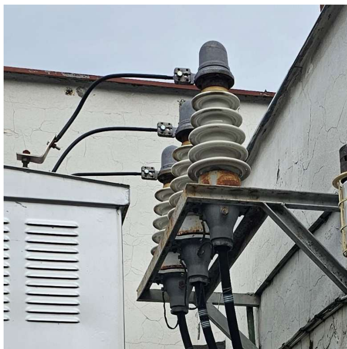
Obr.2 Pôvodné vonkajšie káblOVé koncovky
