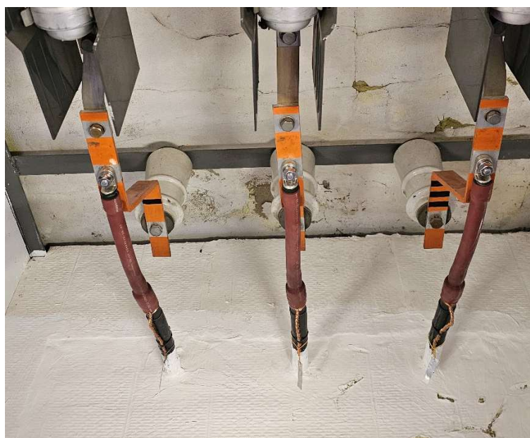
Obr.5 Nové vnútorné káblové koncovky
