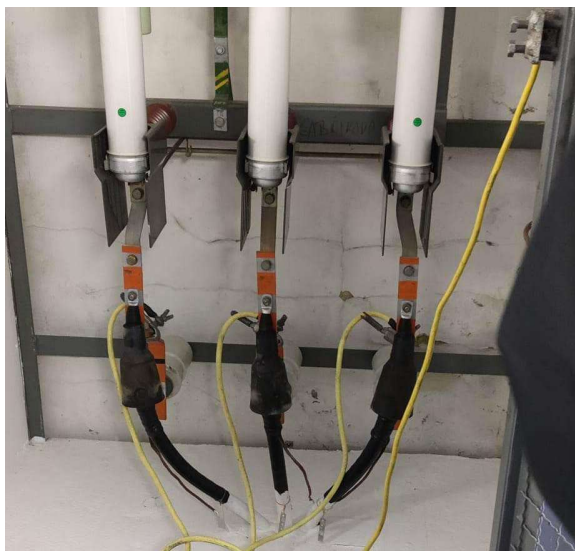
Obr.3 Pôvodné vnútorné káblové koncovky
